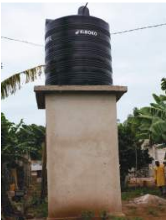
Ujenzi wa mnara wa maji na uwekaji wa tangi la maji Kajengwa
